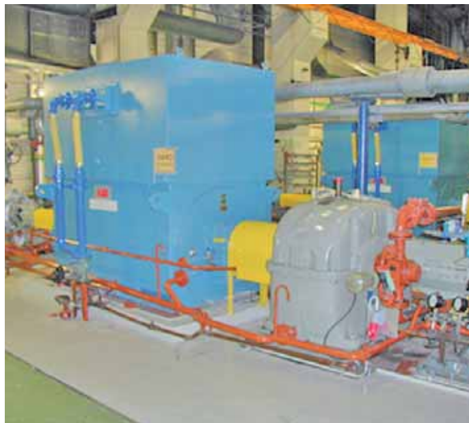
给水泵驱动系统：齿轮箱（前）、主泵（右）、双轴感应电机后面的升压泵。
