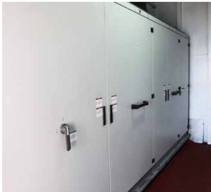
现场 ACS 1000 柜体图
