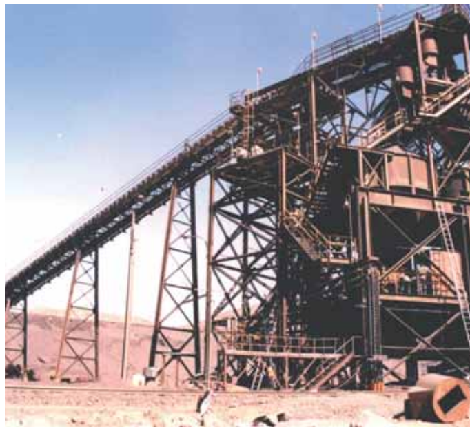
由针对现有400kW感应电机改进的ACS 1000变频器驱动的带式输送机图，它被安装在输送机最上面的平台上。
