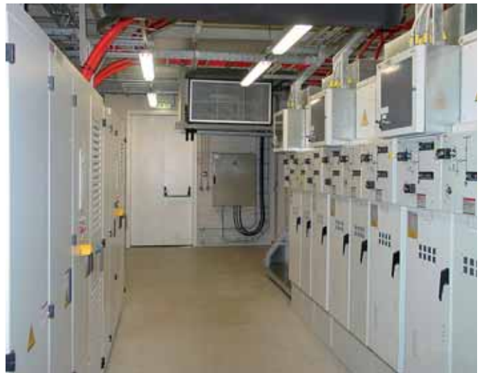
容纳ACS 2000变频器(左)和UniMix开关柜(右)的控制室
