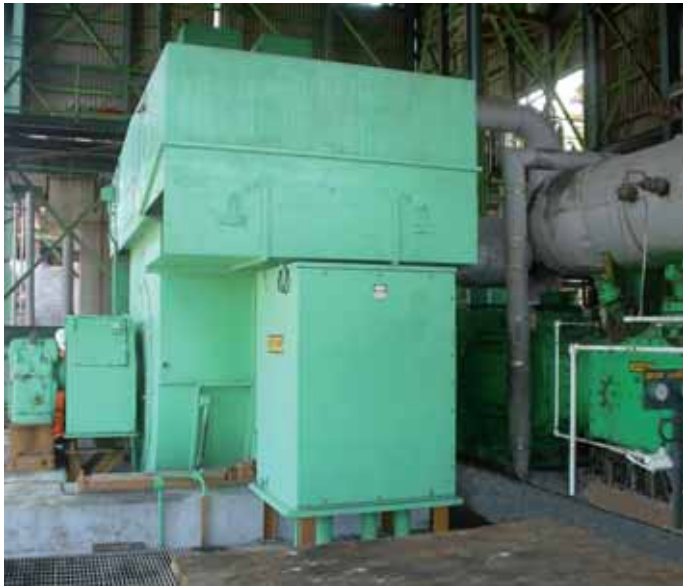
电机和压缩机图 (5,500 kW)
