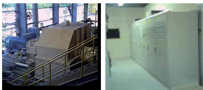
图为Compania Azucarera Hondurena公司Santa Matilde制糖厂的甘蔗压榨机（862 kW）及用于控制甘蔗压榨机的ACS 1000变频器。
